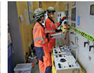
受配電設備点検
