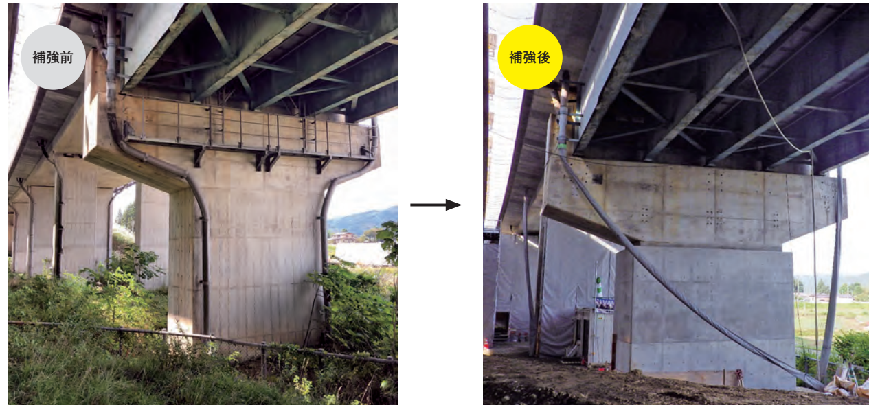
塩沢橋耐震補強工事_巻き立て工事の様子_(三用川橋(下り線)P4橋脚)
